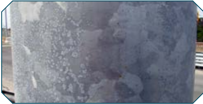
Ilustración 7: Mancha de oxidación por almacenamiento leve
